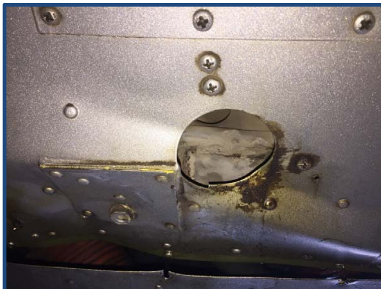
Fotografía No.: 14 Daño por deformación a la estructura.
