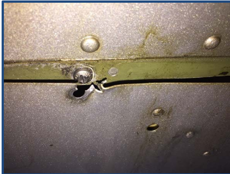
Fotografía No.: 13 Daño observado a las sujeciones de la estructura.
